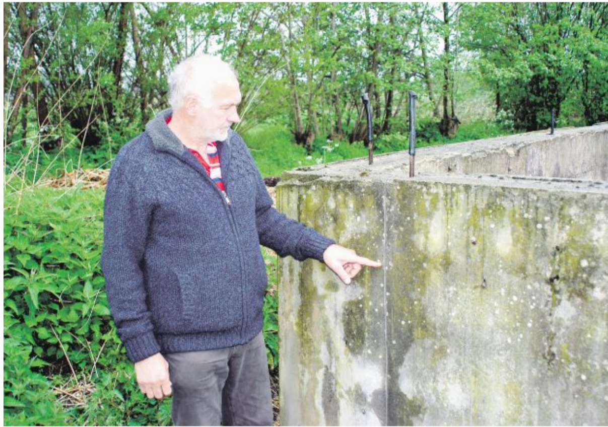
Otto Göllner deutet auf den Riss, den die Bauarbeiter mit dem Trennschleifer am Dienstagabend beim vergeblichen Versuch, die Grundstücksmauer einzureißen, hinterlassen haben. Foto: Mätzig
